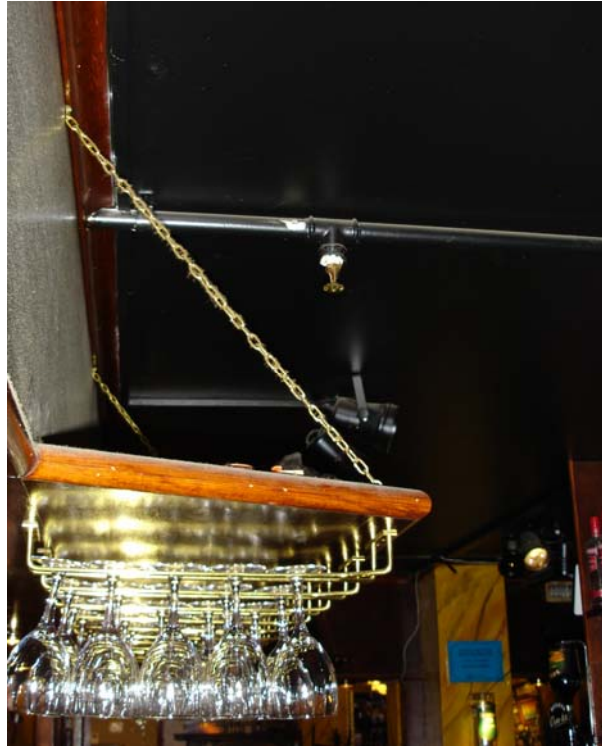
Figur 3.2: Olycklig placering av sprinklermunstycke.
