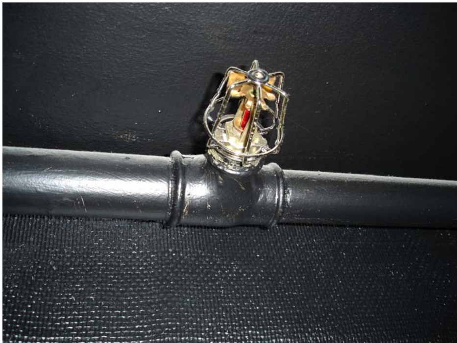
Figur 3.3: Sprinklerhuvud med röd bulb.
