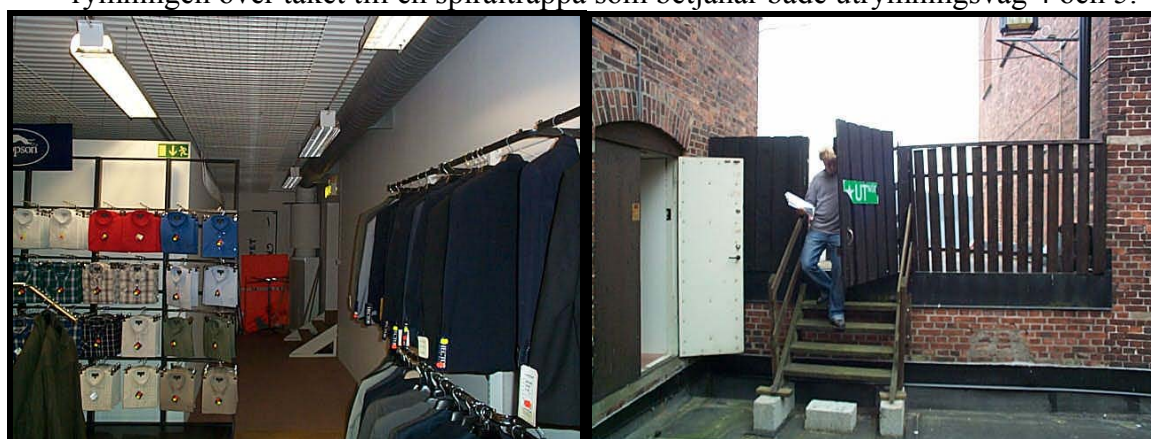
Figur 3.6. T.V. Passage till utrymningsväg 5. T.H. Trägrinden som måste forceras för att utrymma.
