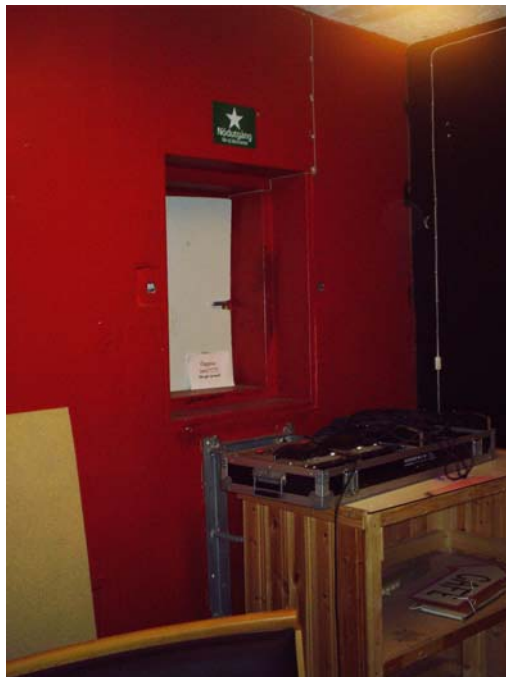
Bild IV. Blockerad utrymningsväg. Skyddsrum.
