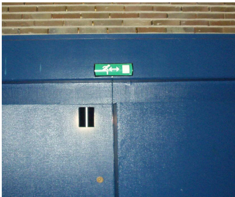
Figur 2.3 Bild på en något förvirrande nödutrymningsskylt.
