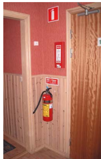
Figur 3. Uppsättning av brandsläckare och brandfilt i korridor
