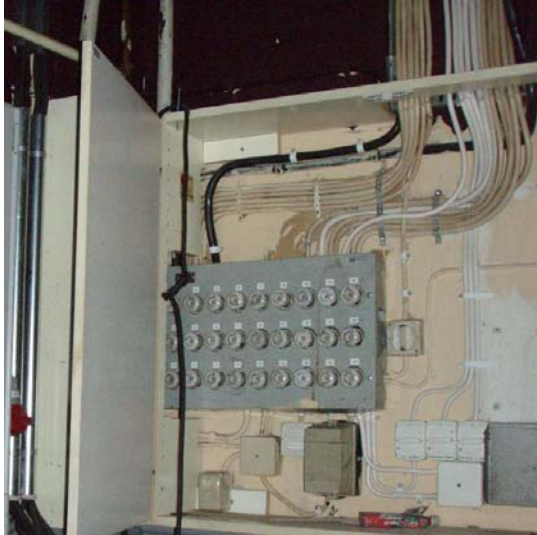
Bild 10.2. Bild på elskåpet i nordöstra hörnet av stora salen. Foto: Jakob Dahlqvist 2006.
