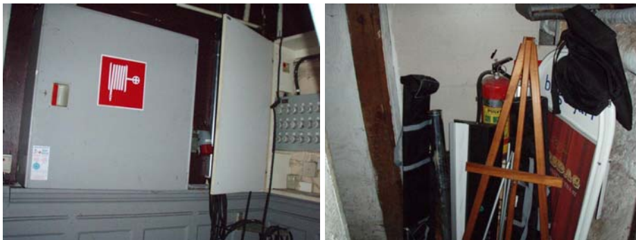
Bild 4.1 och 4.2. Bild från stora salen på inomhusbrandpost och bild från källaren där en pulversläckare är delvis blockerad. Foto: Jakob Dahlqvist 2006
