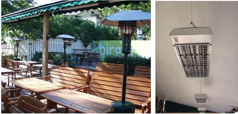
Bild 12.10 och 12.11. Bild på uteserveringen samt ett infrarött värmeelement som är direktmonterat på markisen. Foto: Jakob Dahlqvist 2006
