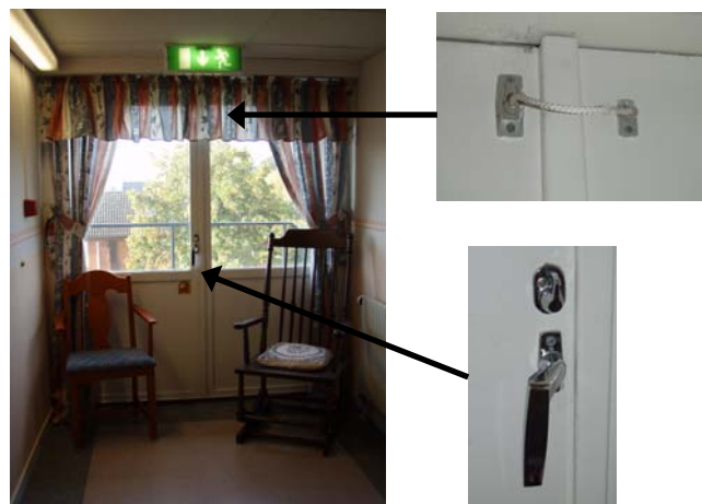
Figur 4.2: Bilderna visar en blockerad utrymningsväg samt låsanordningen på denna.
