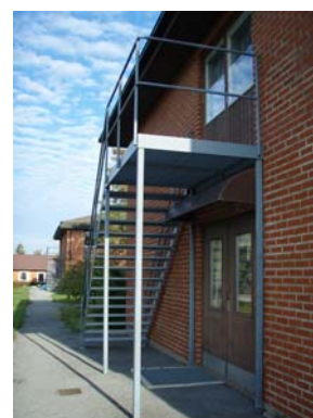
Figur 4.1: En utrymningsväg från plan 2 utgörs endast av en trappa.
