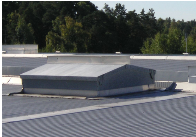
Figur 4.3: Brandgaslucka med smältbleck ovanför Willy:s.
