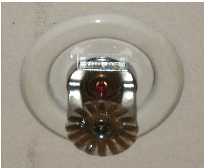
Figur 4.2: Sprinklerhuvud på Veddesta Centrum
