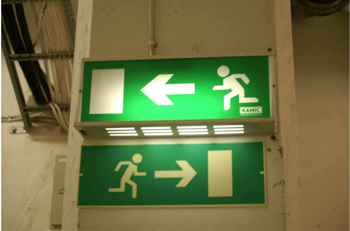
Figur 6.1. Exempel på vilseledande markeringar i utrymningsväg.
