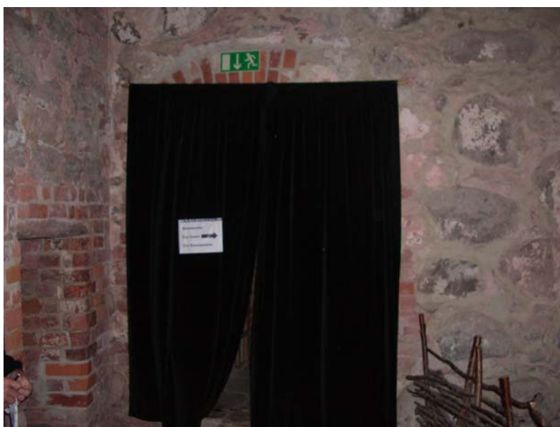
Figur 8 Skynke i utrymningsväg: I rum V208 fungerar ett skynke som rumsavskiljare i en utrymningsväg. Dessutom är utrymningskylten efterlysande.
