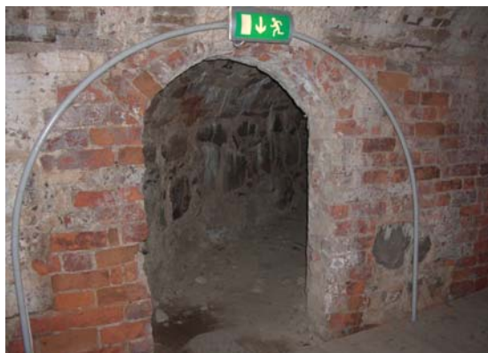
Figur 7 Utrymningsväg kanongång: I den nordvästra kanongången sker utrymning genom utrymmen med låg takhöjd, ojämnt underlag och dålig belysning.
