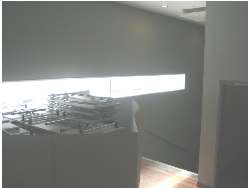
Bild 3.6 Förvaring av bord i trapphus 3, som även är en utrymningsväg.
