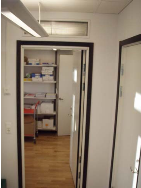
Figur I:9 Uppställd dörr samt felplacerat överluftsgaller
