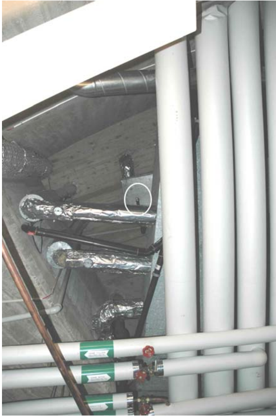
Figur 5:1 Effekten av sprinklern kommer att begränsas av olämplig rördragning.
