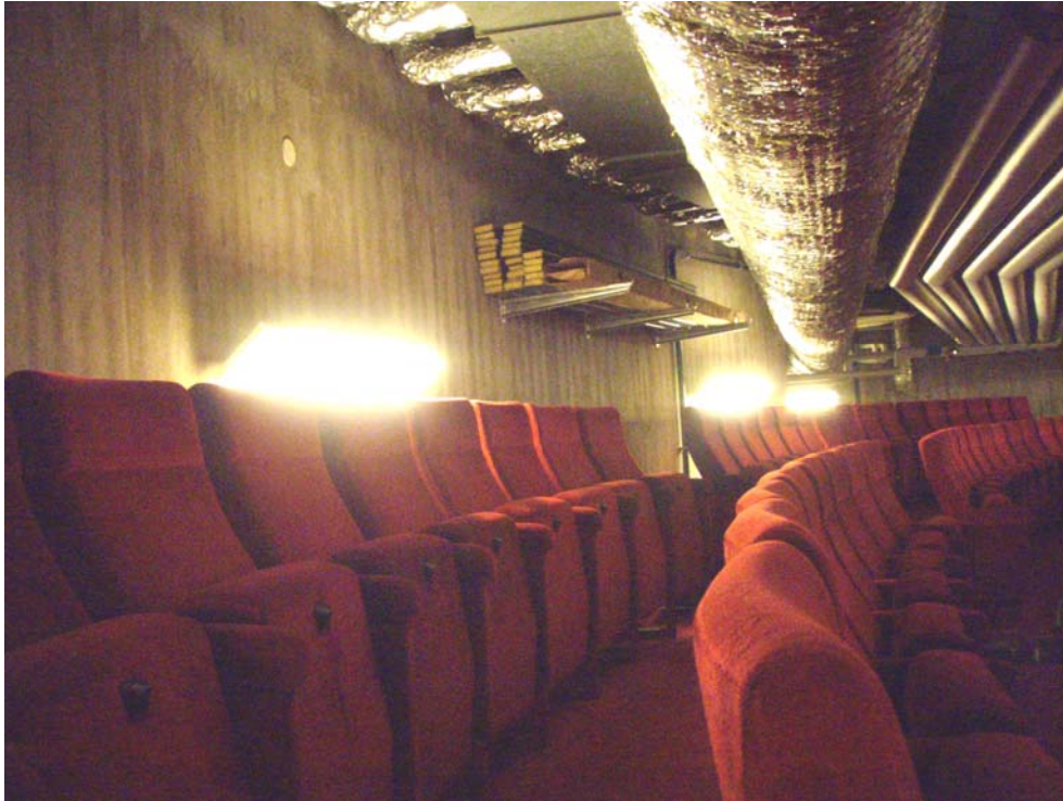
Figur 7: 3 Defekta lysrör utgör potentiell antändningskälla
