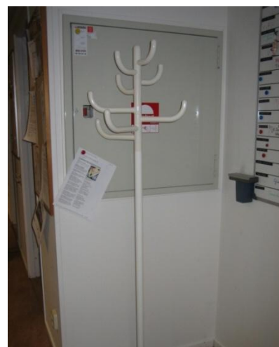
Figur 4.2 – Inomhusbrandpost blockerad av klädhängare
