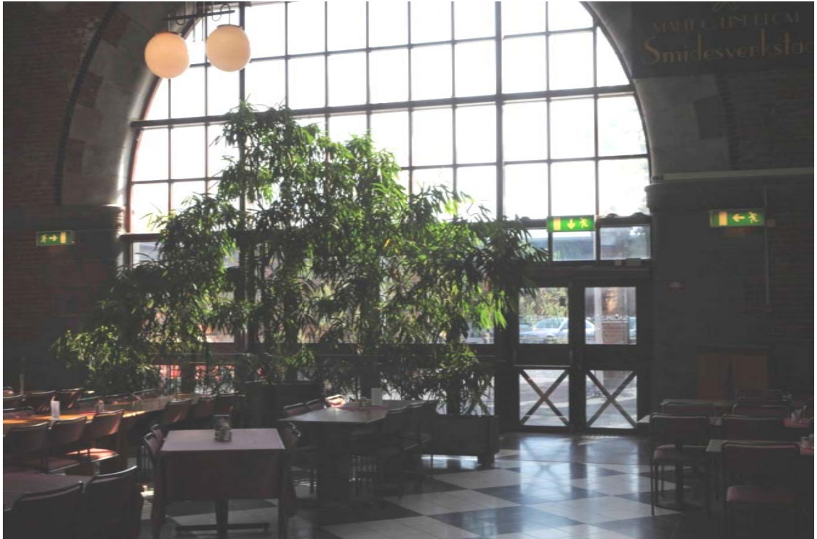
Figur 8.1: Bild utvisande blomlåda som delvis blockerar utrymningsväg.
