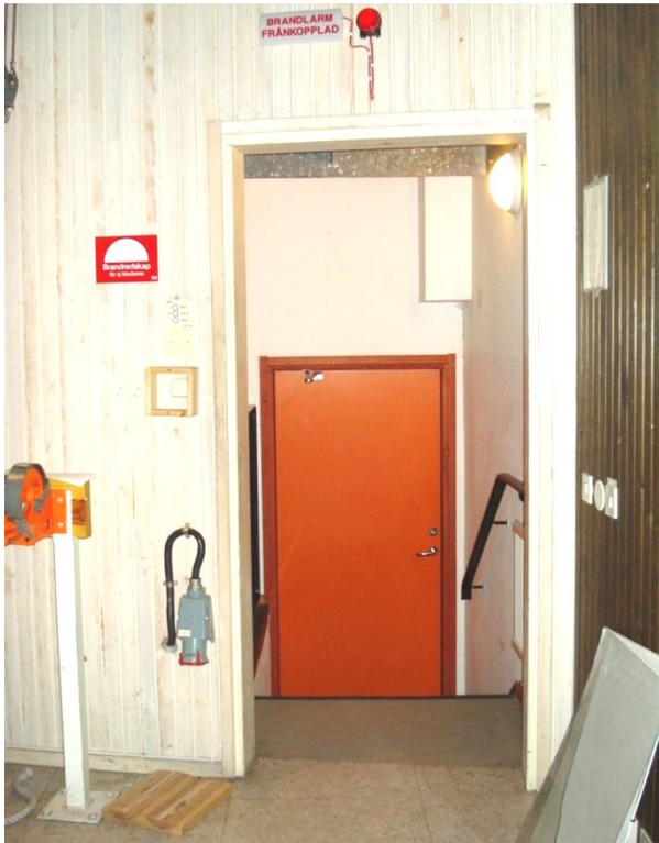
Figur 24. Visar utrymningsväg från scenen i aulan som saknar utrymningsskylt.
