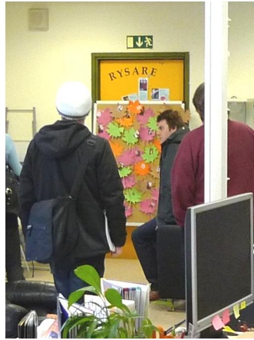
Figur 21. Visar en blockerad utrymningsväg i biblioteket.
