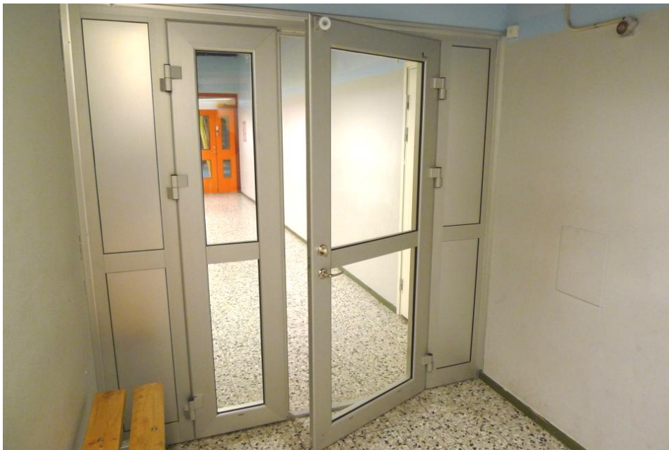
Figur 23. Visar en branddörr (E30-C) i sitt stängda läge. Den står i vanliga fall uppställd mot väggen med hjälp av en magnet.
