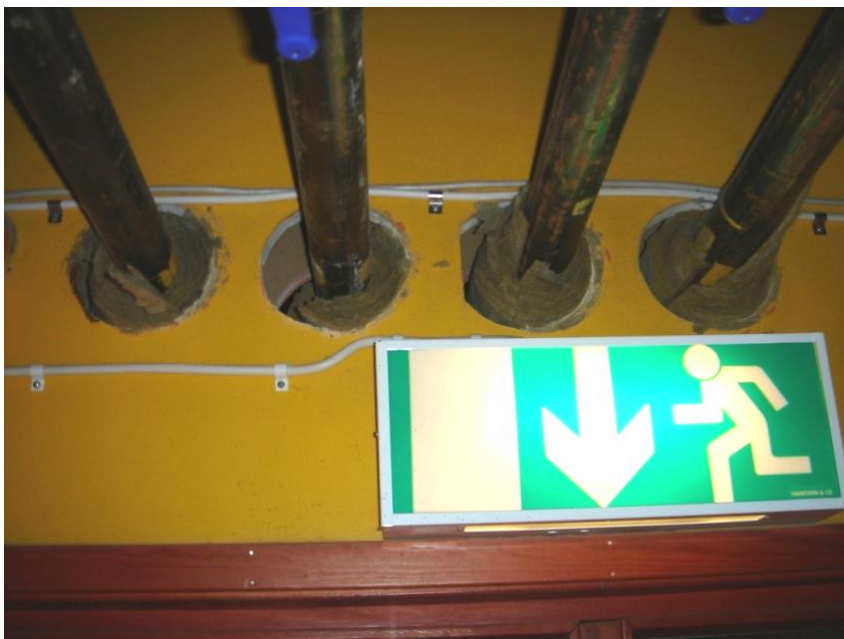
Figur 25. Visar dåligt tätade genomföringar.
