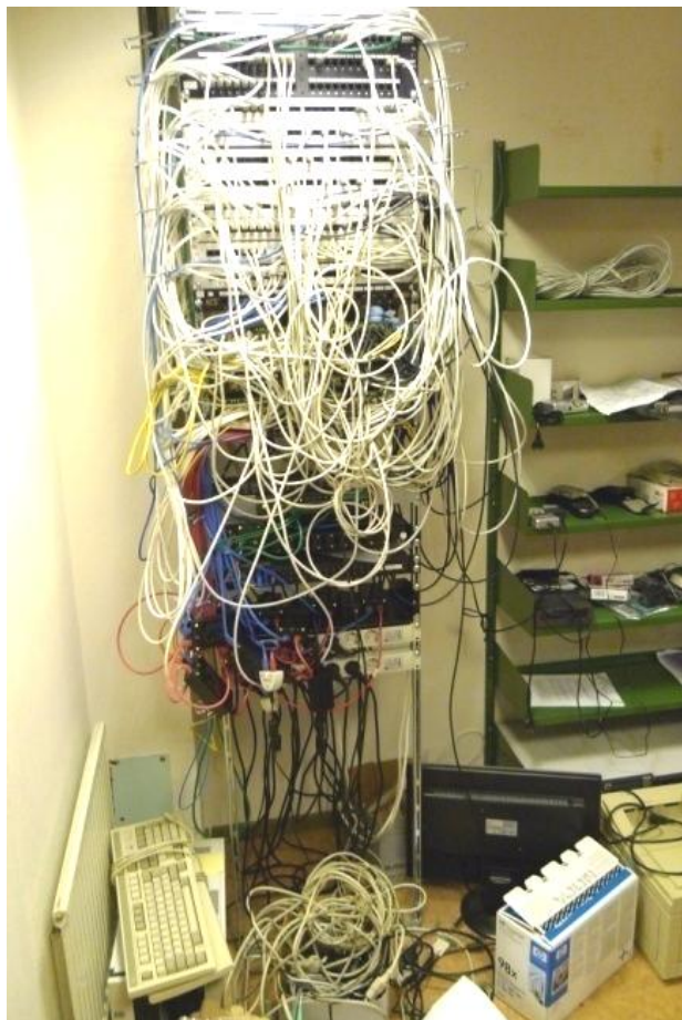
Figur 29. Visar nätverkscentralen i bokförrådet.
