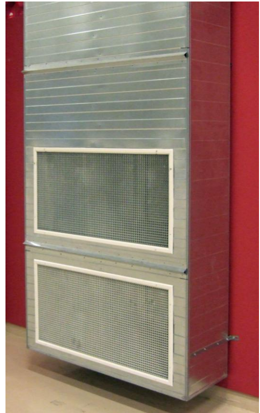
Figur 18. Tilluftsdon för ventilation, foto privat.
