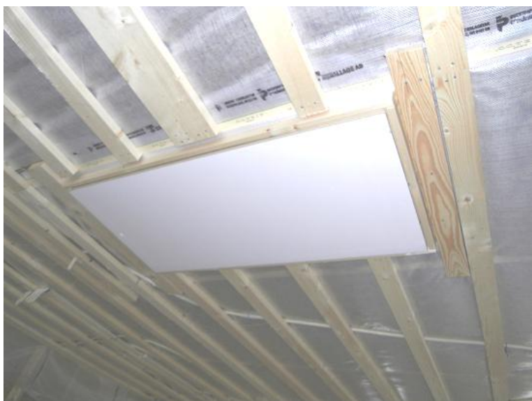
Figur 28 Vindslucka monterad i vindsbjälklag (Platsbesök)
