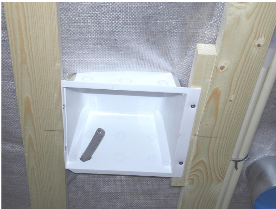
Figur 46 Spotlightlåda som tryckts upp underifrån. I vänstra hörnet är det ett stort hål där läckage kan uppstå (Platsbesök).
