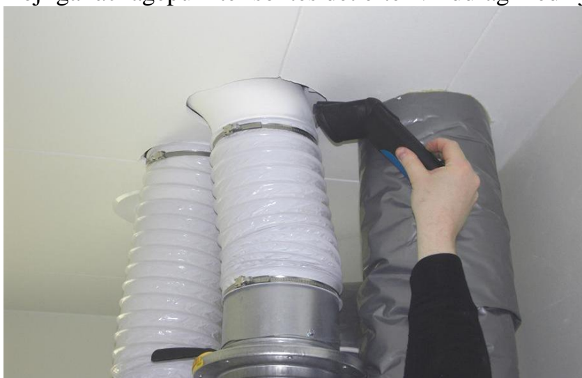
Figur 5 Läcksökning med rökgas vid rör till och från FTX-aggregat
