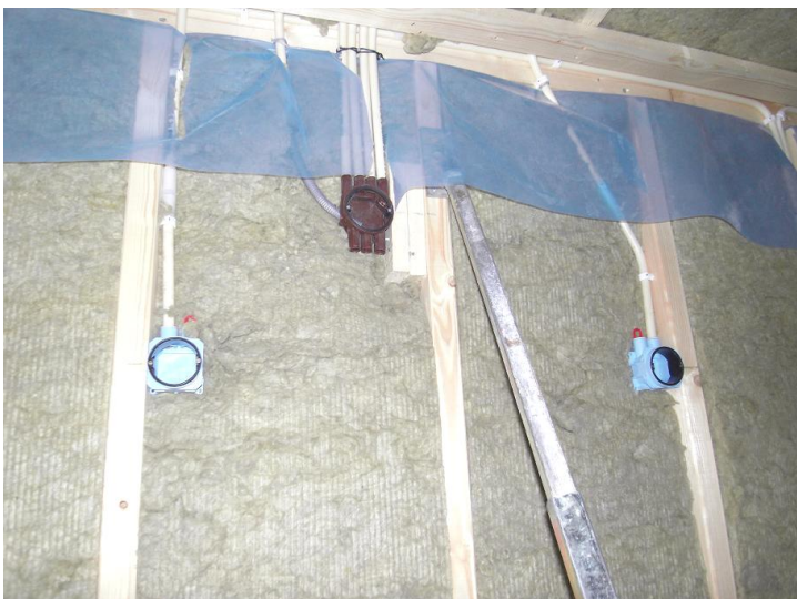
Figur 3 Slarvigt uppskuren plast vid mellanbjälklag
