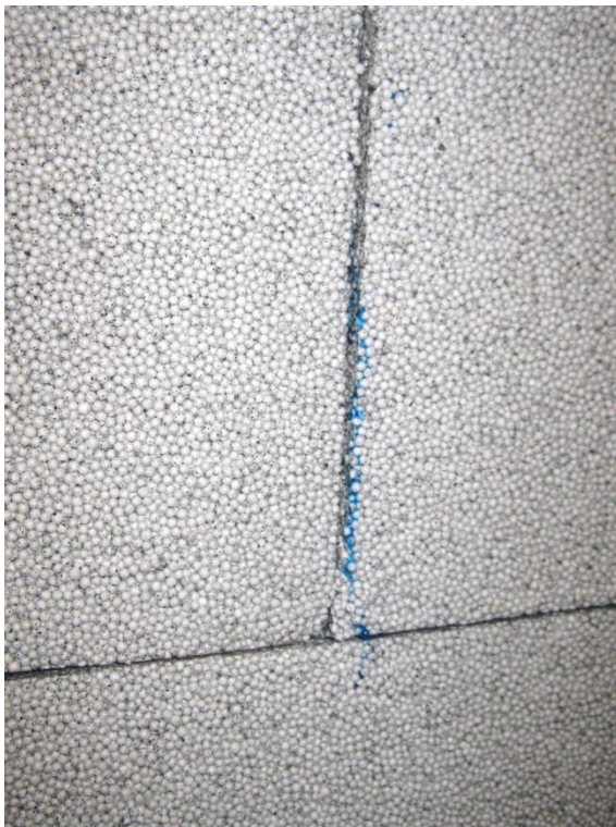
Bild 8.4 Vatten har trängt ut genom den lodräta skarven till baksidan av väggen.
