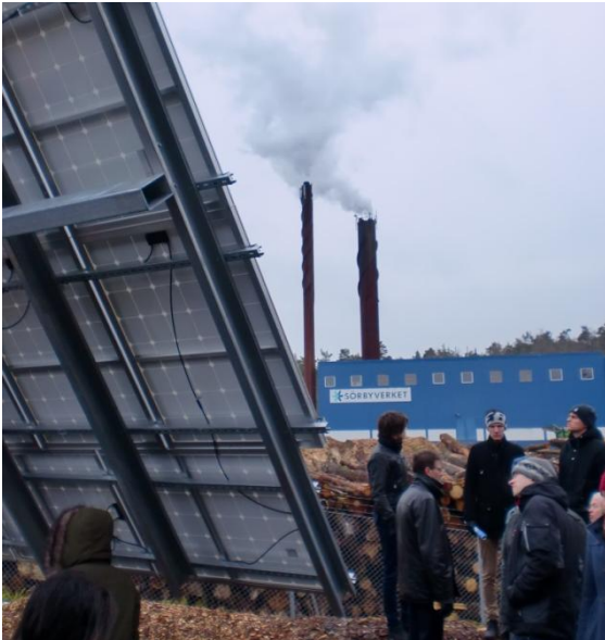
Bild 5.6 Sörbyverket, en solcells- och biobränsleanläggning i Ronneby kommun (Nevzudin Mukic, 2011).
