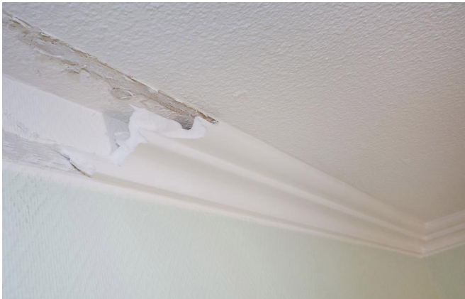
Figur 1.5 Ett grängat tak där en del av taklisten tagits bort (Zatzy).
