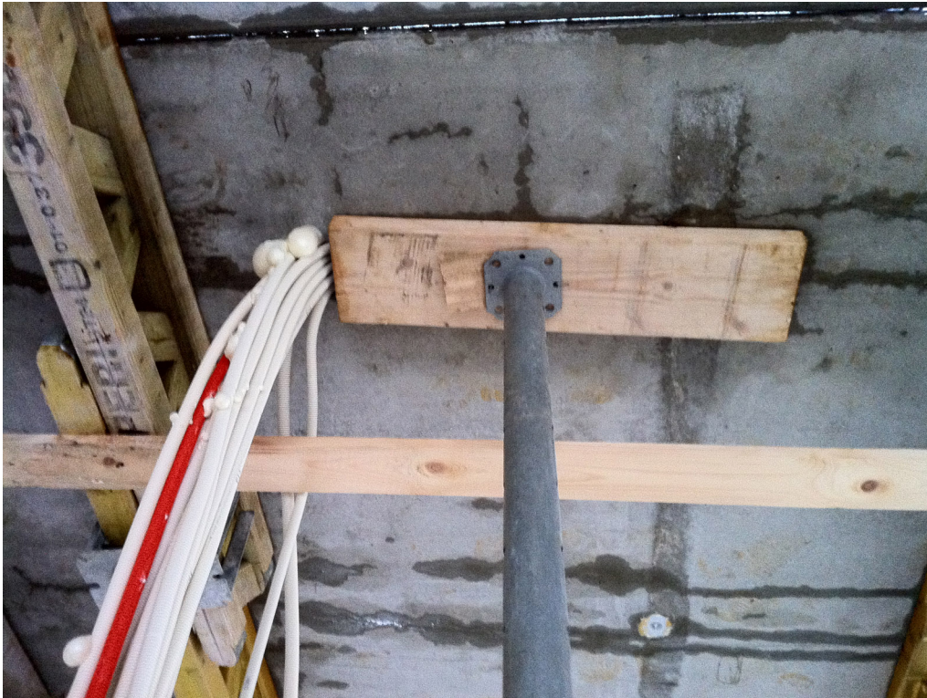
Figur 2.5 Förstärkning i stämning p.g.a. kapade armeringsstegar.
