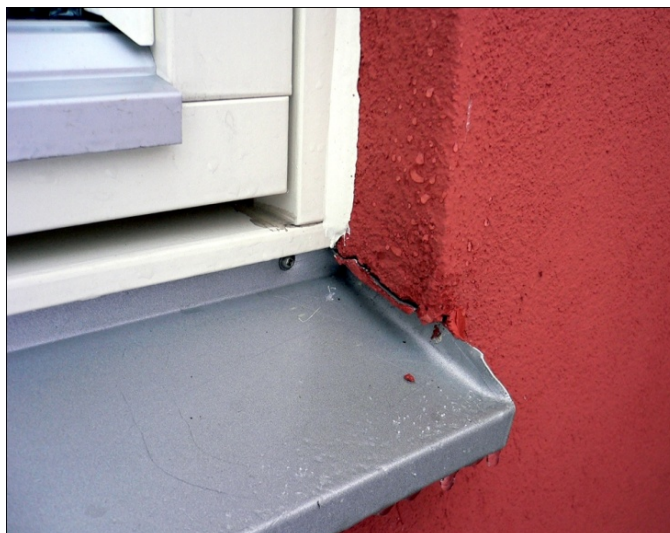
Figur 2.8. Otäthet vid fönsterbleck. Källa: SP 2009.
