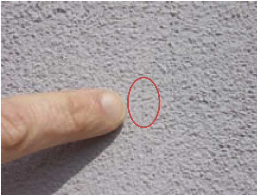
Figur 2.10. Ytterligare exempel på spricka från SP 2009. De beskriver att genom denna spricka har det runnit in vatten efter regn som efter 10 minuter har fuktat cellplasten på insidan. Källa: SP 2009.
