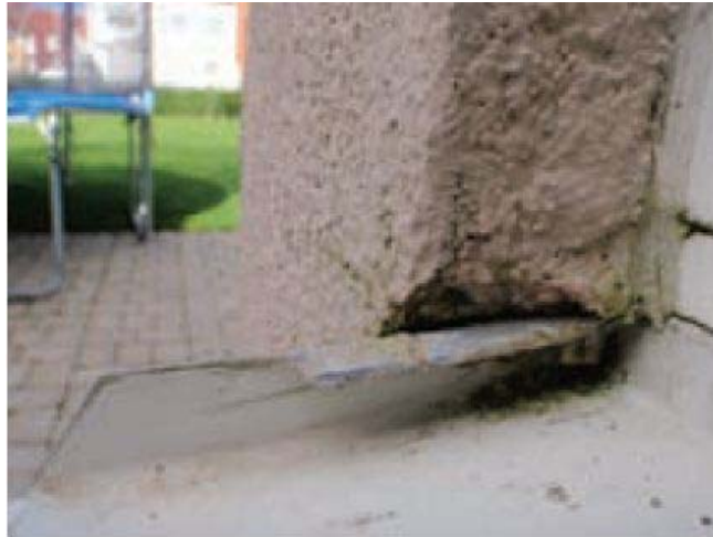
Figur 2.12. Spricka vid dörranslutning. Källa: SP 2009.
