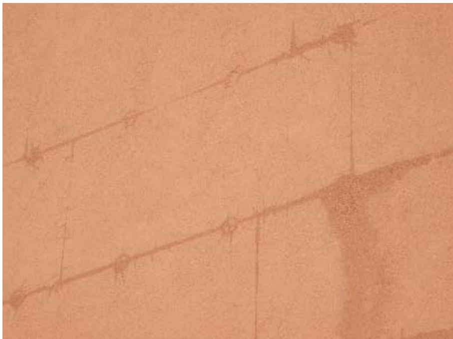
Figur 2.9. Tunnputsfasad med synliga sprickor. Källa: Kenneth Sandin.
