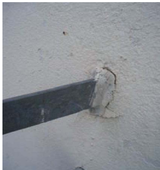
Figur 2.14: Spricka vid infästning. Källa: SP 2009.
