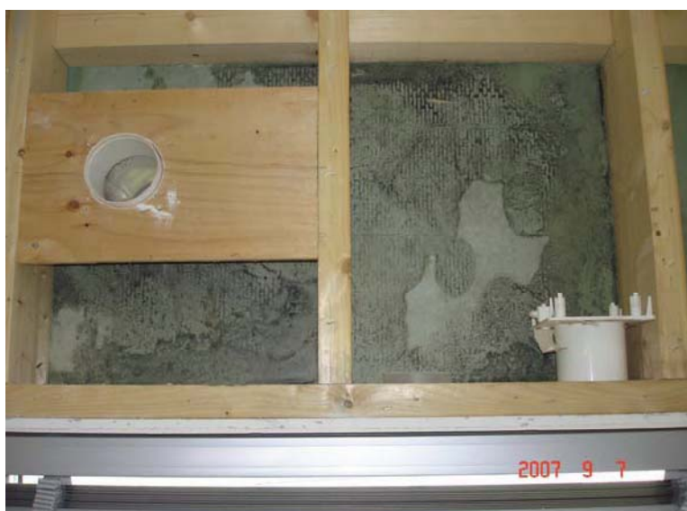
Figur 2.6. En gipsskiva som har möglat, sedd från insidan. Källa: Kenneth Sandin.
