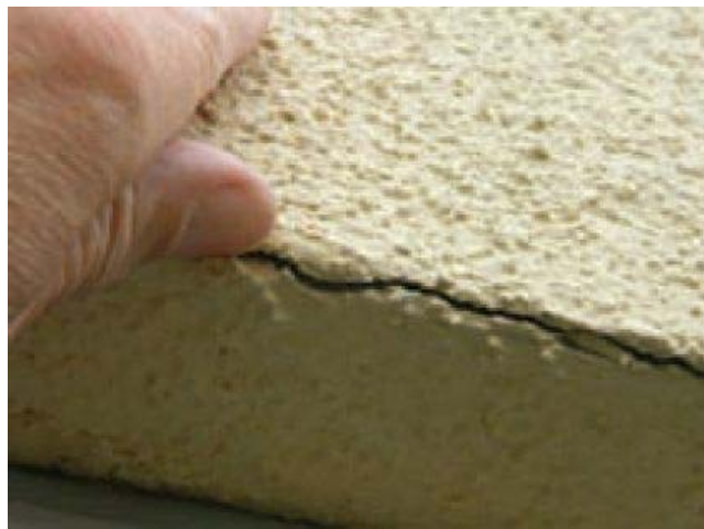
Figur 2.13. Spricka vid hörn ovanför fönster . Källa: SP 2009.
