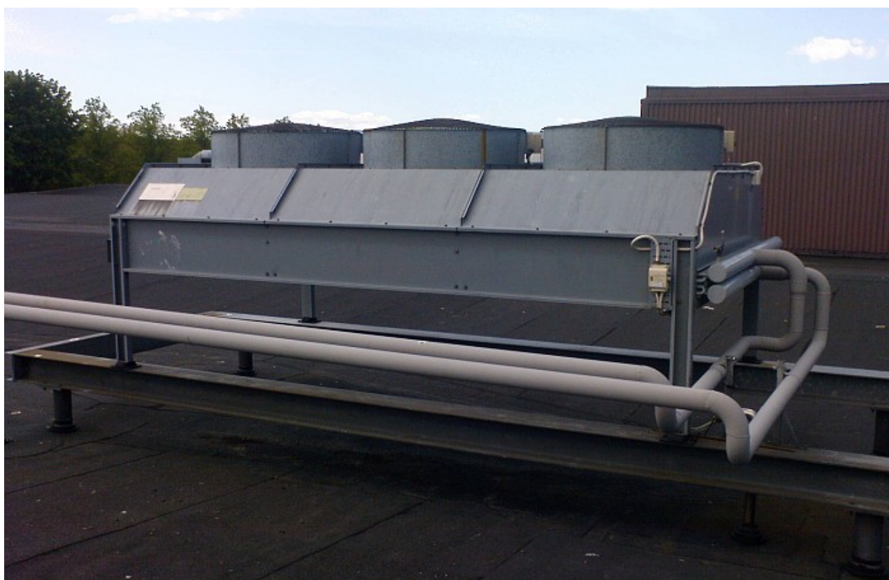
Figur 6: Vätskekylaren på taket.
