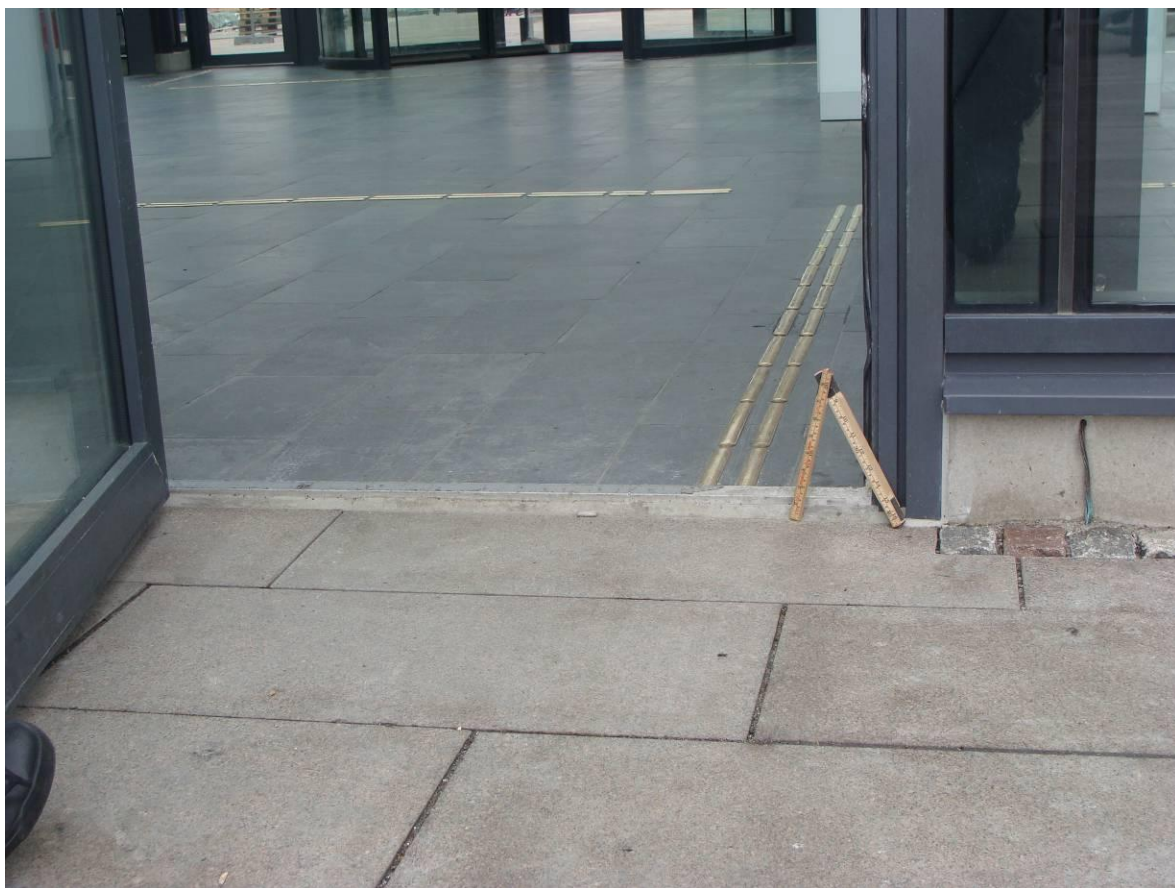
Figur 9: Bilden visar en dörrtröskel som ingår i den hinderfria gångvägen vilket inte uppfyller höjdmåttet vid Malmö Centralstation. Foto: Nader Saber.
