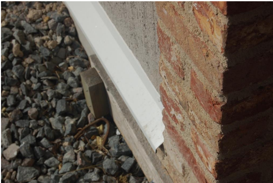
Figur 31: Dräneringsplåt över fasadsockel för att hindra vatteninträning
