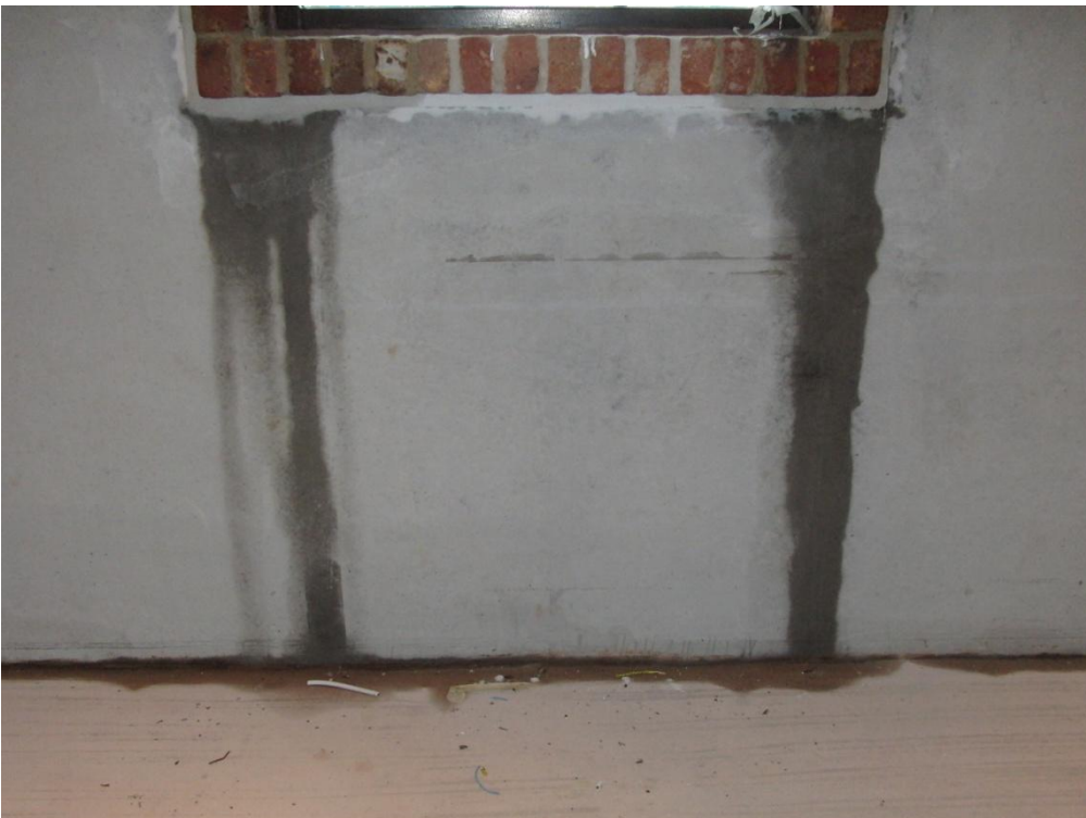
Figur 29: Rinnande vatten på insidan av väggen vid fönster infästning (Olsson, 2011)
