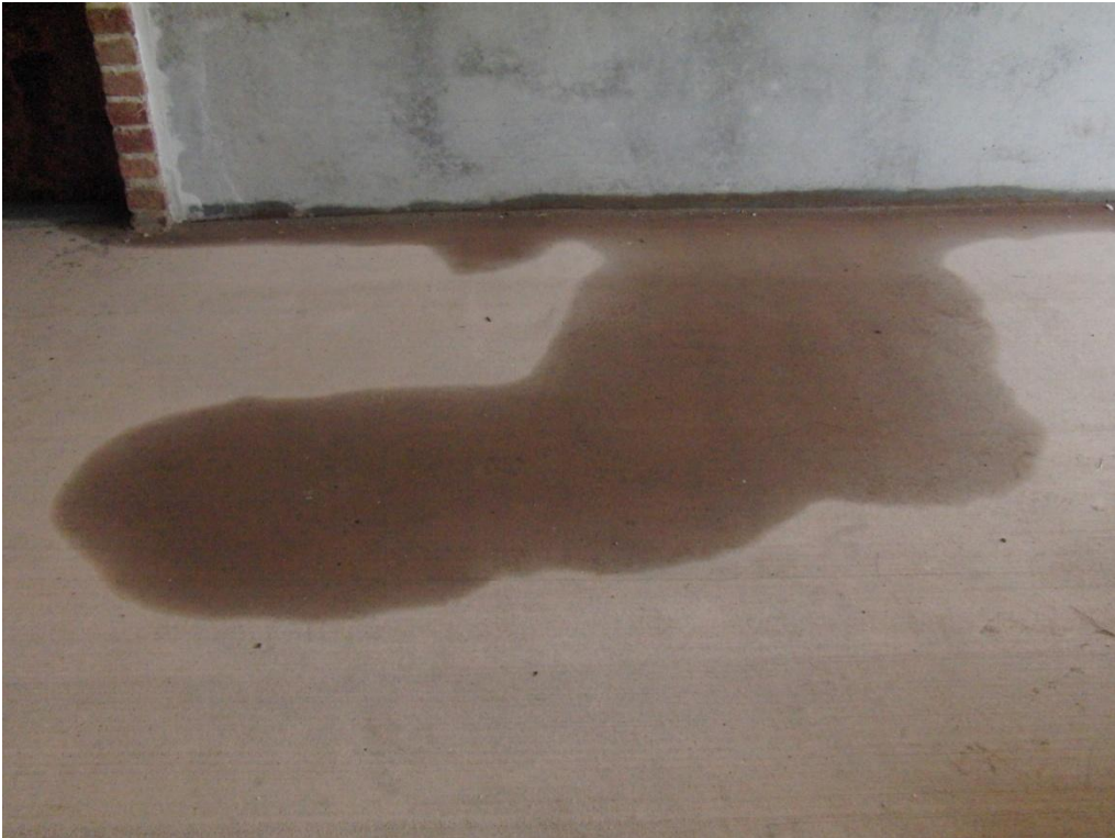
Figur 28: Vattengenomträngning till insidan av väggen vid väggsockel (Olsson, 2011)
