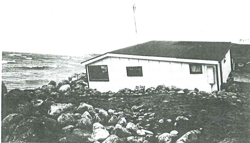
Fig. 2.5. Ett hus underminerades under en storm månadskiftet januari/februari 1983 (foto R. Åhman1983).
