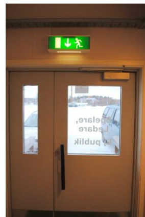
Figur 2.9 – Dörr till det fria.
