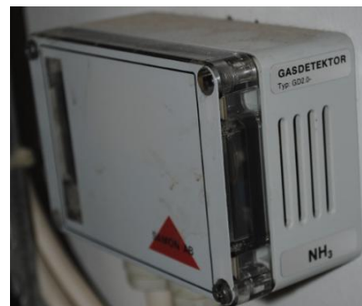
Figur 2.16 – Ammoniakgivaren i frysmaskinsrummet.
