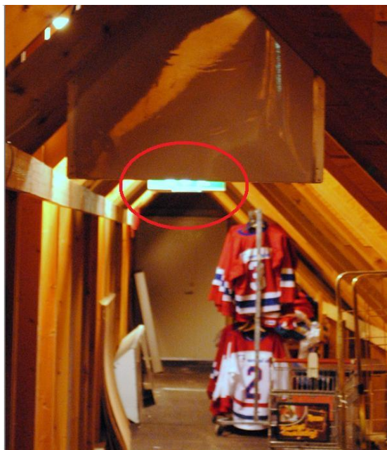
Figur 7.4 – Dold utrymningsskylt i gång under läktare.
