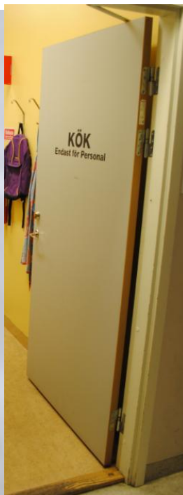
Figur 7.3 – Dörr mellan brandcell 1 och 2.
