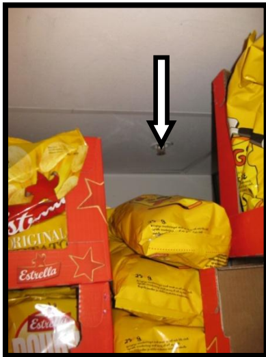
Figur 5.2 Sprinkler ovanför chipshyllor på Hemköp.
