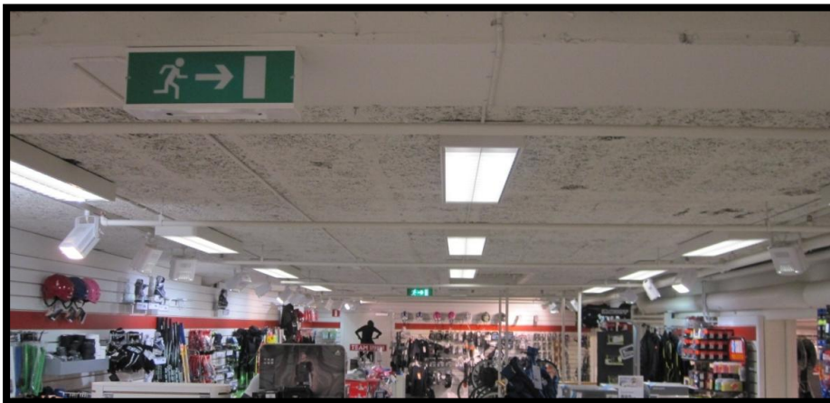
Figur 8.2 Bilden visar två utrymningsskyltar. En är släckt och en genomlyst.
