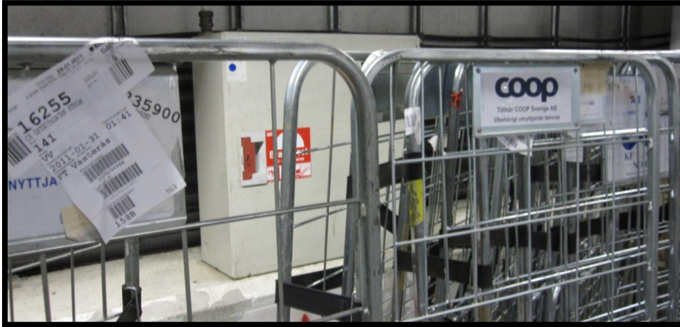
Figur 8.1 Blockerad brandpost på källarplan.
