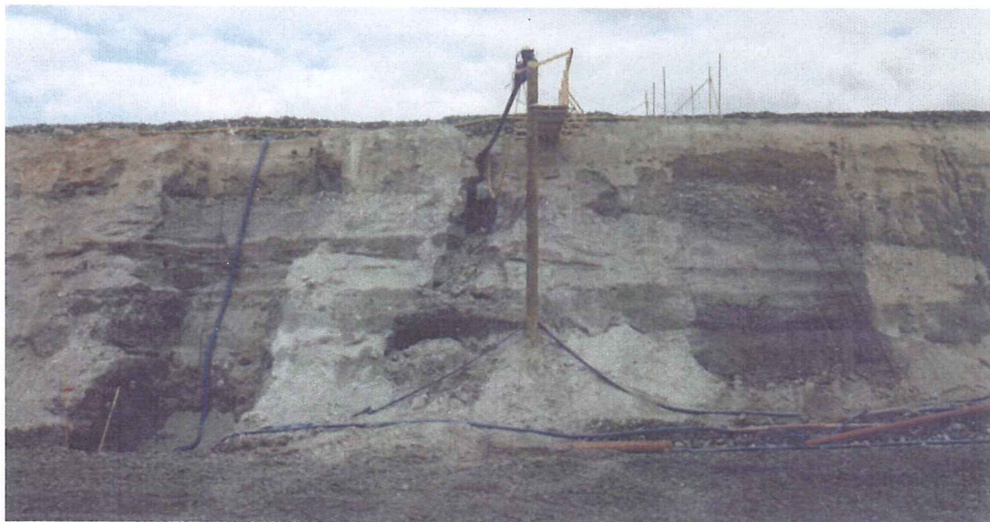
Fig. 17. Översikt från det detaljstuderade området i skärning 2. A-skärningen finns till vänster om den blå slangen, B under slangen och C till höger vid stegen. Den övre diamiktonen är ett jämntjockt (ca 1,2-1,5 m) lager. Den undre delen består av många komplext lagrade diamiktoner och sorterade sediment.
