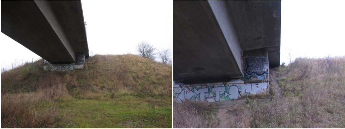
Bild 4: Stig upp till spår område på bandel 912 vid kilometerskyt 603+550. Staket finns på västra sidan av bron men inte på östra
