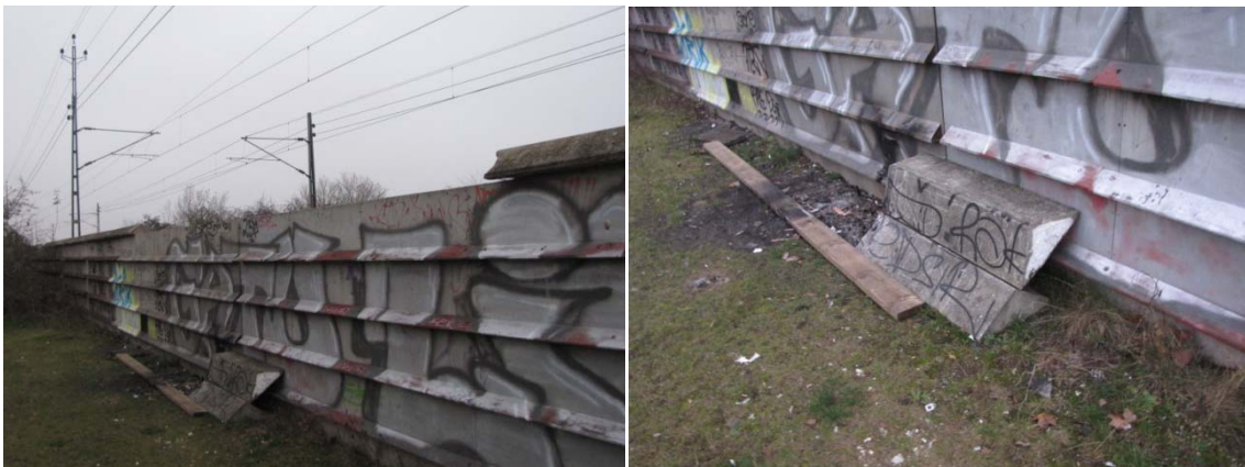
Bild 5: Sabotage av bullerplank på bandel 901 vid kilometerskyt 622+150
