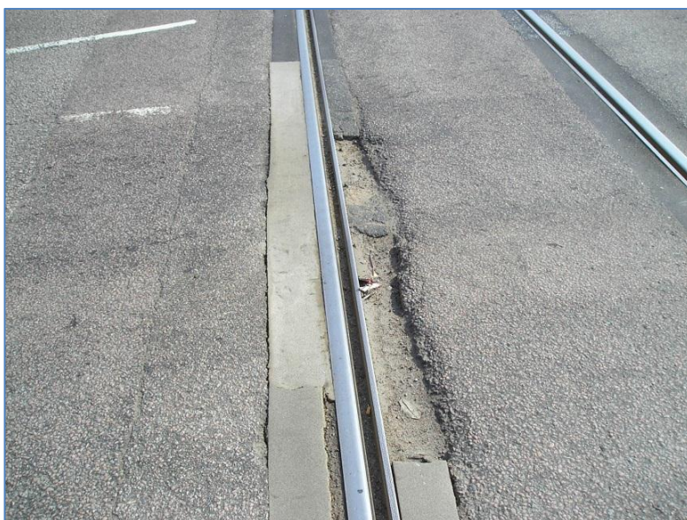
Figur 14: Sprickbildning, asfaltsyta. Källa: Alberto Pina (2012).
