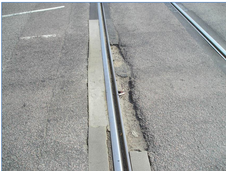
Figur 14: Sprickbildning, asfaltsyta. Källa: Alberto Pina (2012).
