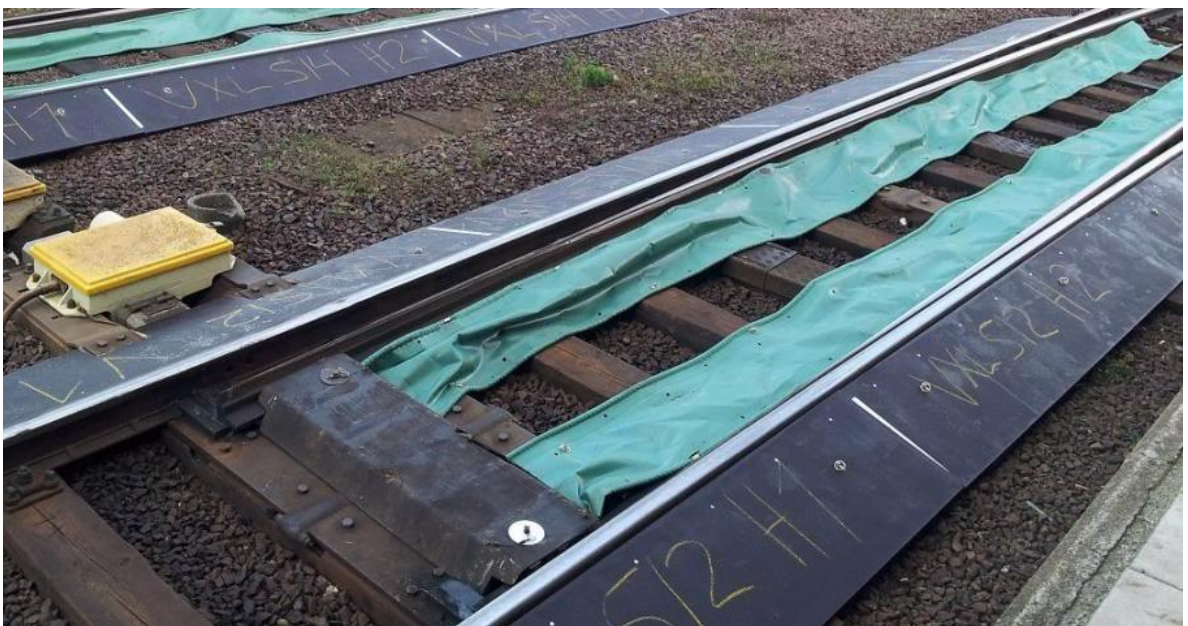
Figur 5 Spårväxel med plywoodskivor och presenningar som snöskydd (Brofalk, 2012)
