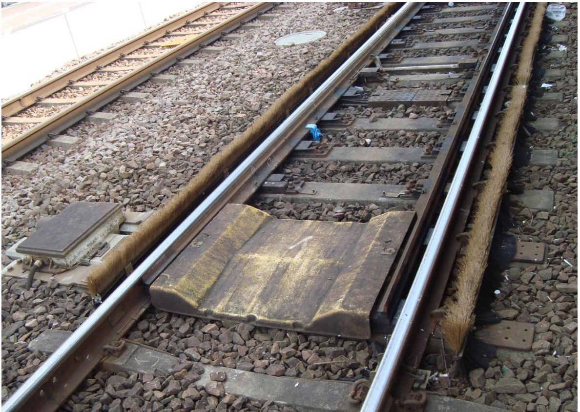
Figur 4 Spårväxel med borstar som snöskydd samt kåpa över dragstänger.
