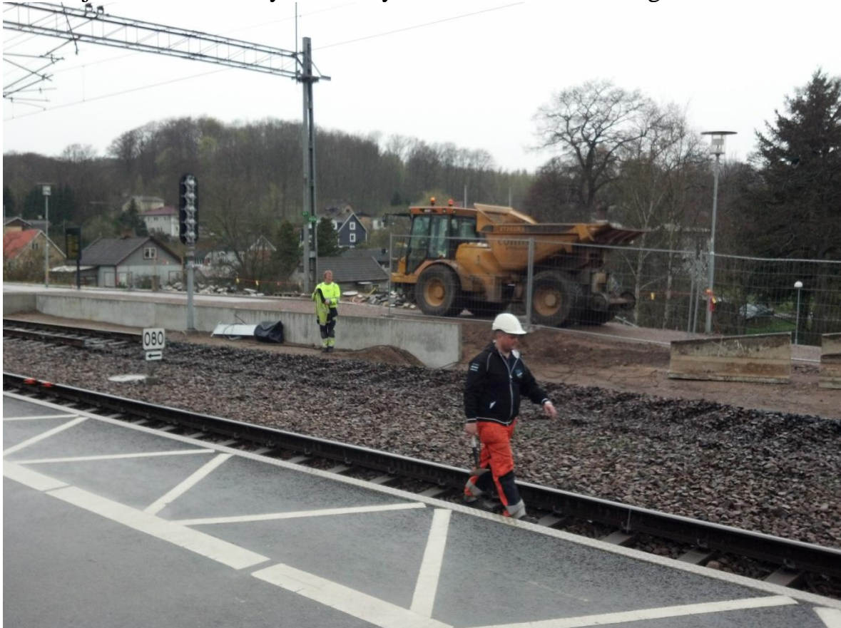
Bild 13: Dumper som väntar på att fyllas med den gamla makdamen som växel 32 b låg i innan
