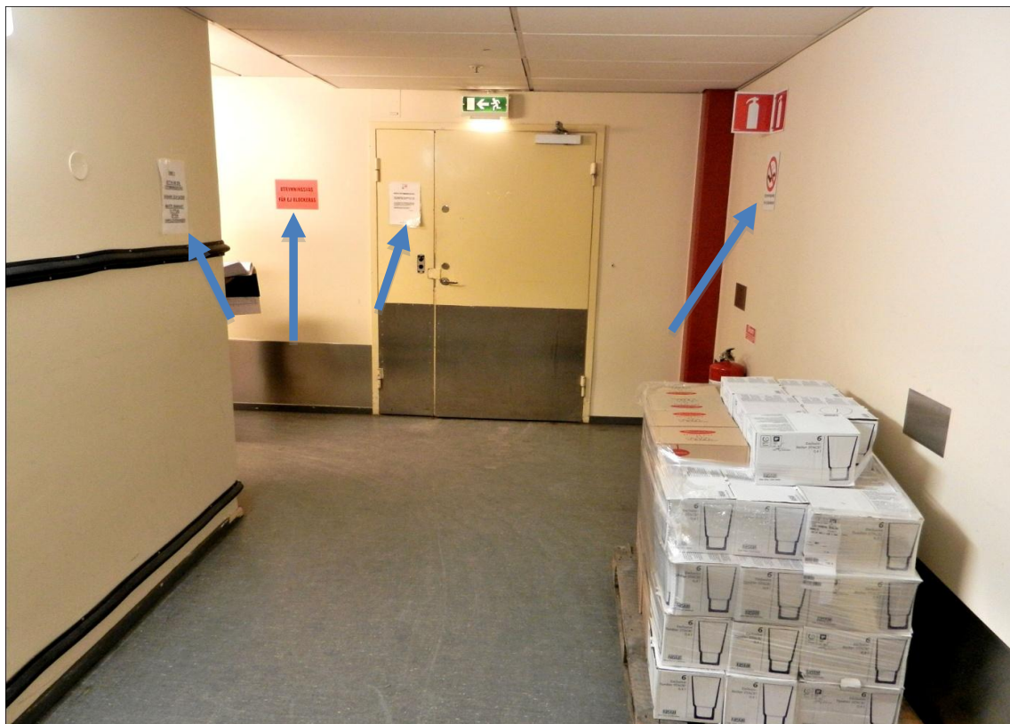
Figur 4.3 Lastpall placerad i utrymningsväg trots anvisningar om att detta ej är tillåtet.
