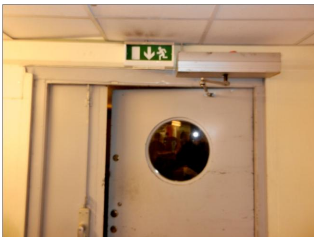
Figur 4.4 Utrymningsdörr i brandcellsgräns som ej går att stänga.
