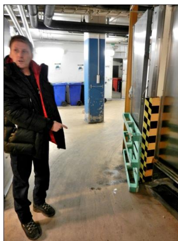
Figur 4.2 Dörr i brandcellsgräns uppställd med EU-pall.
