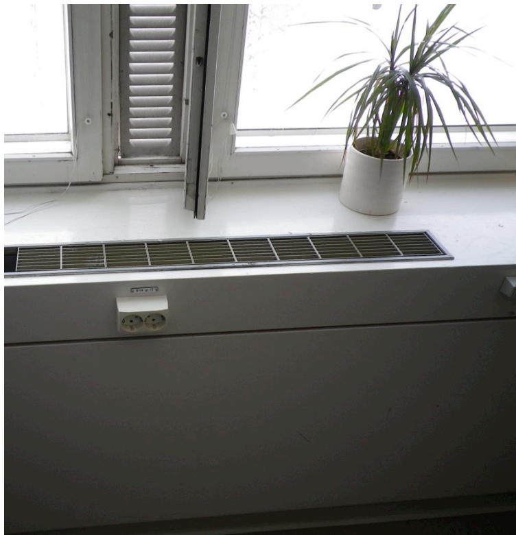
Figur 2.5. Fönsterapparat för tilluft i patientrum.
