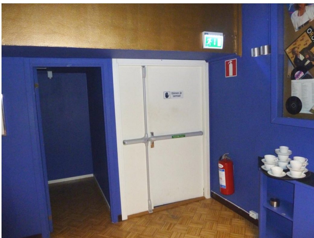
Bild 3.2. Exempel på utrymningsväg på Wallmans. Observera "Dörren är larmad"-skylten mitt på dörren.
