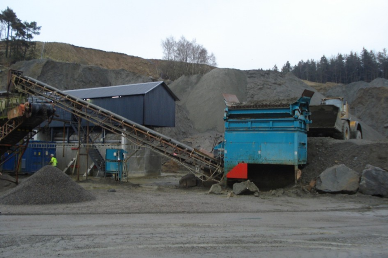
”Figur 5 Inmatning av det krossade materialet. Bilden visar behållare där materialet matas in samt transportbandet. I den vänstra delen av bilden kan en Swerock anställd ses för att ge ett hum av anläggningens storlek. Bild Fredrik Nylén ”
