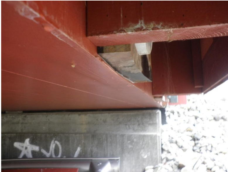
Figur 24. Lokalt brott på grund av expansion i trädäcket (Moelven, 2012)
