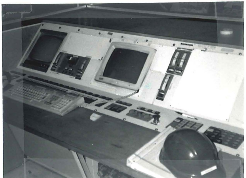
Fig. 48: Bild över kontrollrummet där temperaturutvecklingen i ugnen övervakades.
