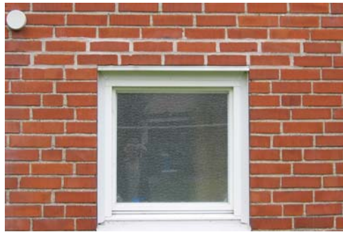
Figur 3-6. Renoverad fasad med avvikande kulör och storlek på fogar över fönsteröppning, Måsvägen, Lund.
