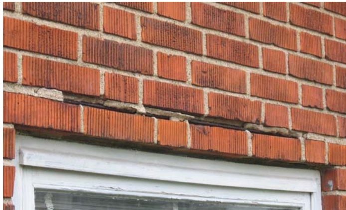
Figur 2-3. Blottad armering och nerhängande tegelskift p.g.a. rostsprängning. Bilden tagen på Margretedal, Lund, september 2005.
