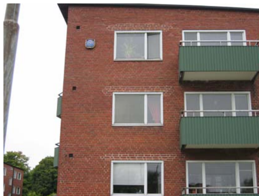
Figur 3-11. Avvikande fogkulör ovanför fönsteröppningar, Kakelvägen, Lund.
