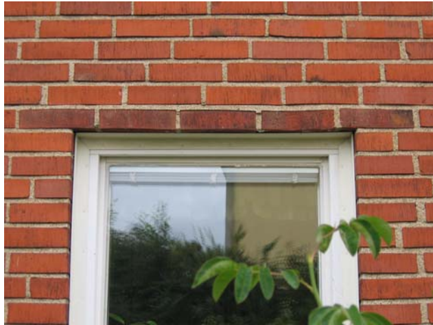
Figur 3-13. Armerad tegelbalk med avvikande kulör med armeringskorrosion, Måsvägen, Lund.
