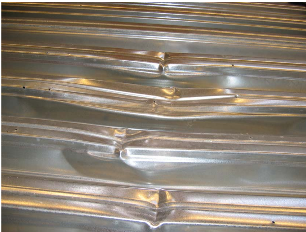
Bild 3 Plåtens utseende (översidan) efter belastning till brott med punktlast.
