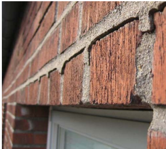
Figur 1. Korroderande armering har pressat ned tegelskiftet samtidigt som murbruket har pressats ut.
