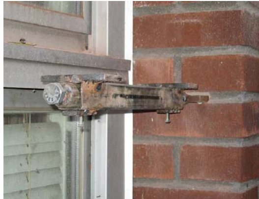
Figur 29. Fogbräcka i väggen.
