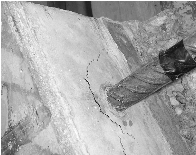
Figur 6.2 Medföljande betong runt armeringsjärnet
