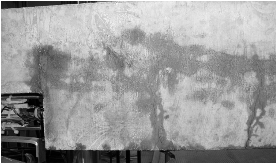
Figur 5.2 Sprickor i ena halvan av en balk synliggjorda genom fuktning av betongytan. Sprickavståndet som mäts är från kanten på utskärningen till nästa spricka.
