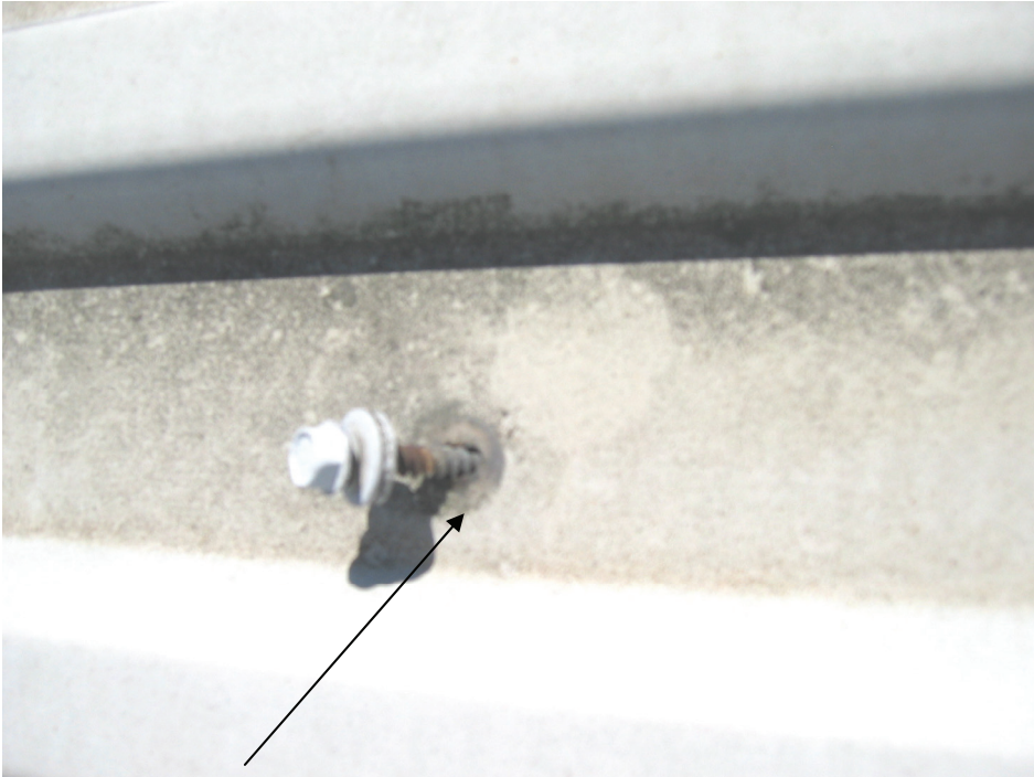
Figur 5.3 Skruv som lossnat pga. hålkantsbrott
