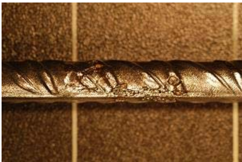
Figur 6.14 Korrosionsangrepp på järn 2 i balk 5 med täcksikt c 20 mm, stålspänning 380 MPa och diameter 8 mm kloridbelastning underifrån, gradering 2.
