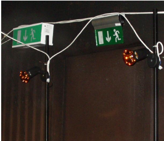
Figur 3. Utrymnings skyltar och blinklampor vid utgång till sidogång. Reproducerad med tillåtelse från Frantzich och Nilsson (2003).
