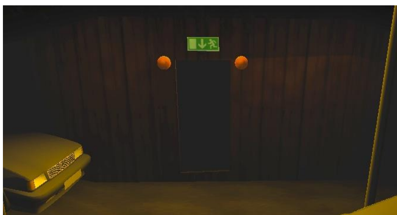
Figur 18. Utgång med utrymningsskylt och lampor.
