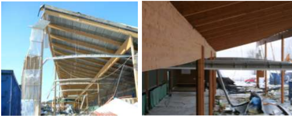
Figur 9.1. Norra delen av Rosvalla Tennishall efter kollaps
