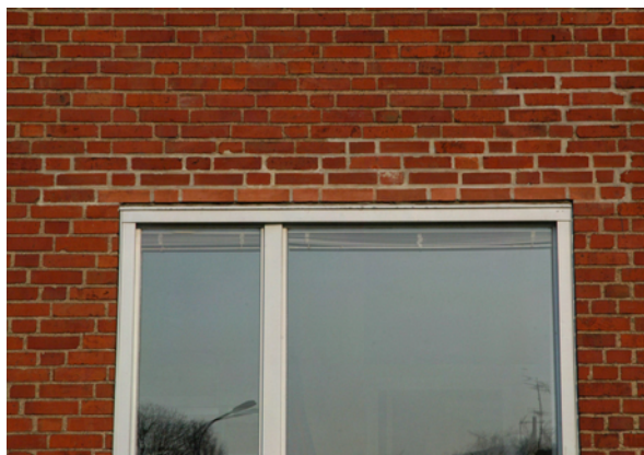
Bild 4.2 Fogar reparerade med murbruk i avvikande färg, Kakelvägen, Lund
