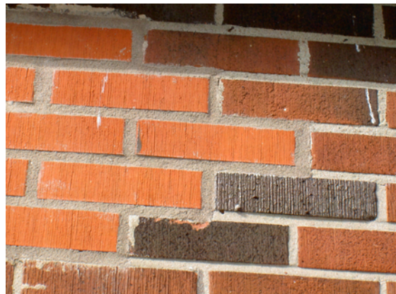
Bild 4.3b Reparerat tegel, murbruk och fogtyp med avvikande färg och form, Vildanden, Lund
