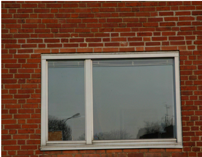
Bild 4.7 Murbruket ersatt med avvikande färg och form, Kakelvägen, Lund
