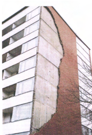
Bild 3.4 Ras av en skalmursfasad på Klostergården i Lund i samband med stormen Gudrun i januari 2005
