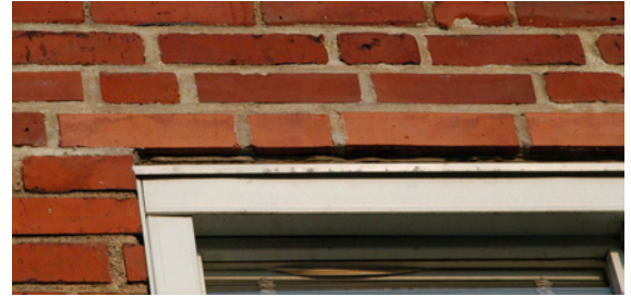
Bild 4.8 Ersatta tegelstenar av avvikande färg, Kakelvägen, Lund
