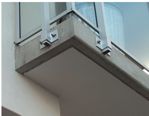
Figur 6 Havshuset är ett exempel på Skanskas stål och betonghus från BO01 mässan i Malmö. På underkanten av plattan är det en springa mot fasaden. Här kan det läcka in vatten då det ofta regnar horisontellt och byggnaden är placerad vid havet.
