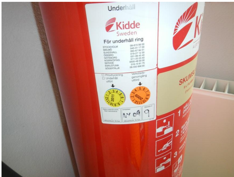
Figur 15. Det senaste underhållet av brandsläckaren utfördes i mars 2011.
