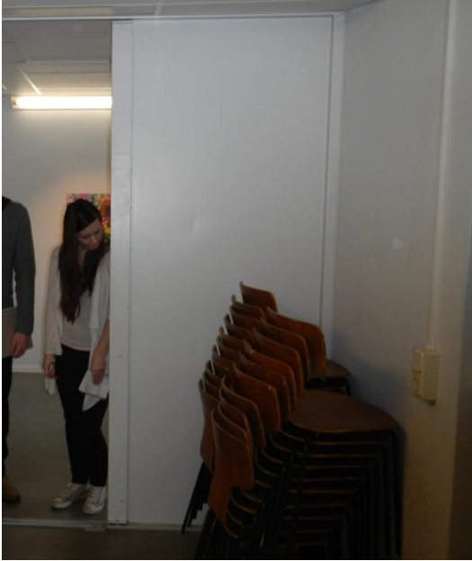
Figur 13. Exempel på hur lös inredning blockerar en del av utrymningsvägen.
